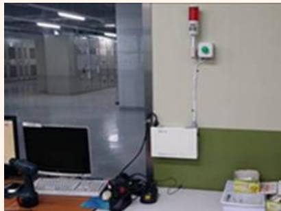
빌딩 전기실 정전 문자
