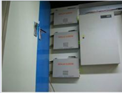
DDC/PLC 연계 문자 통보
