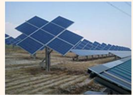
태양광 인버터 장애 감시
